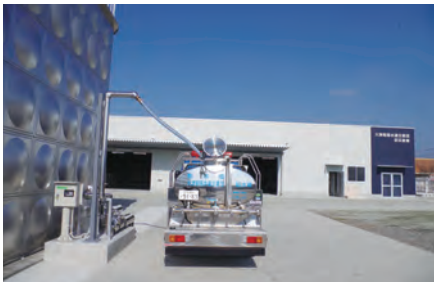
給水車へ補水するための装置
